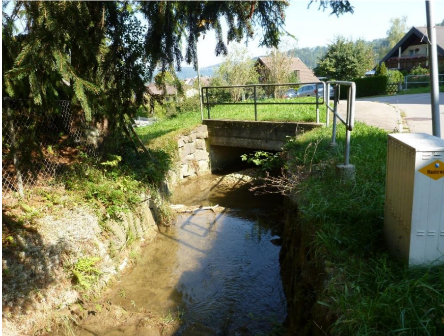
Abbildung 9: Geschiebeablagerungen im Bereich der Brücke Huebwiesstrasse
