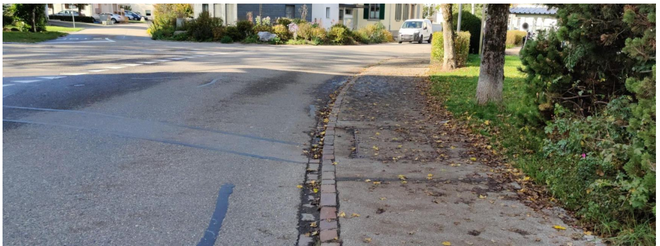
Abbildung 2: Zustand der Strasse im Bereich Tablatstrasse / Stationsstrasse
